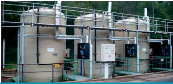
Tank- und Dosieranlagen
